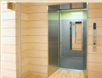
■エレベーター
